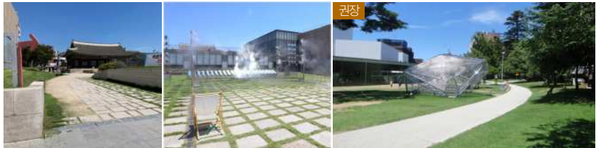
지양: 포장재의 요철로 인해 휠체어 등의 접근이 불편한 관람 동선 권장: 평탄한 포장재로 전시관람 동선을 조성한 사례
