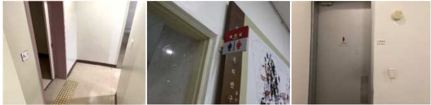
휠체어의 회전반경 미확보 시인성이 낮은 화장실 안내사인 및 픽토그램
