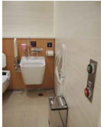
장애인화장실의 벽면을 식별이 용이하게 위생도기와 대비되는 마감재로 처리한 화장실. 또한 손잡이도 매핑처리하여 차가운 느낌을 최소화함
