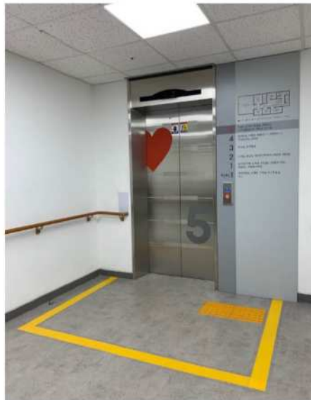
엘리베이터 앞에 영역을 선으로 표시하여 복도 보행자와 엘리베이터 대기자 간의 안전 유지
