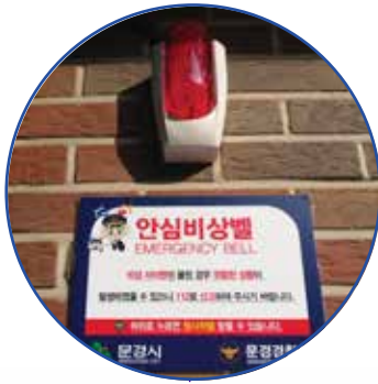
비상벨과 연계된 경광등 설치
