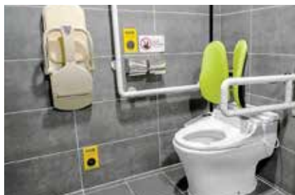
다목적 화장실 내 비상벨
