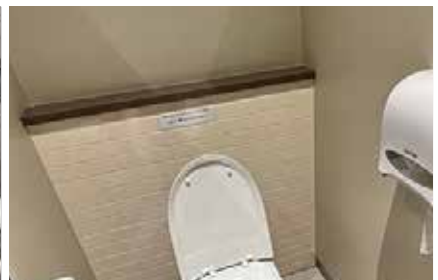
변기 후면에 설치된 선반
