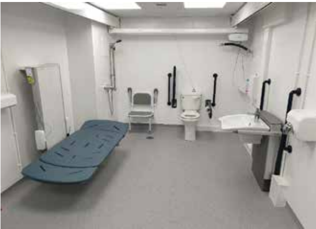
장애인 특수장비(너싱벤치)가 설치된 화장실
