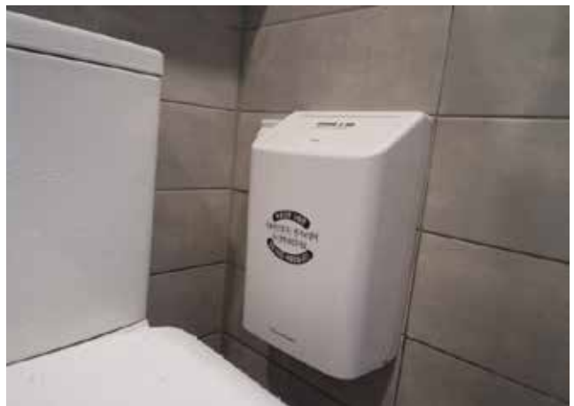
대변기 후면에 설치된 위생용품 수거함
