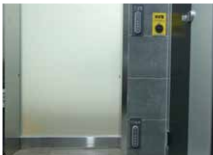
다목적화장실 자동문 스위치 예시
