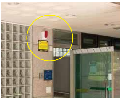
화장실 경광등 설치 예시
