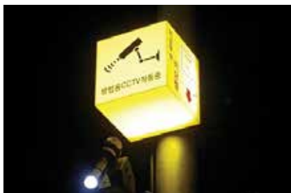
CCTV가 눈에 잘 띄도록 LED 안내표지 박스
