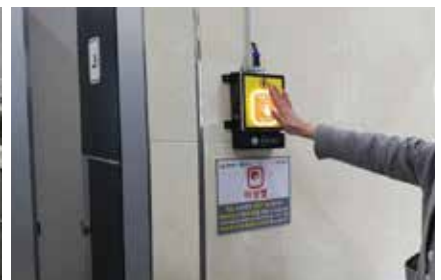
세면대 주변 비상벨 설치
