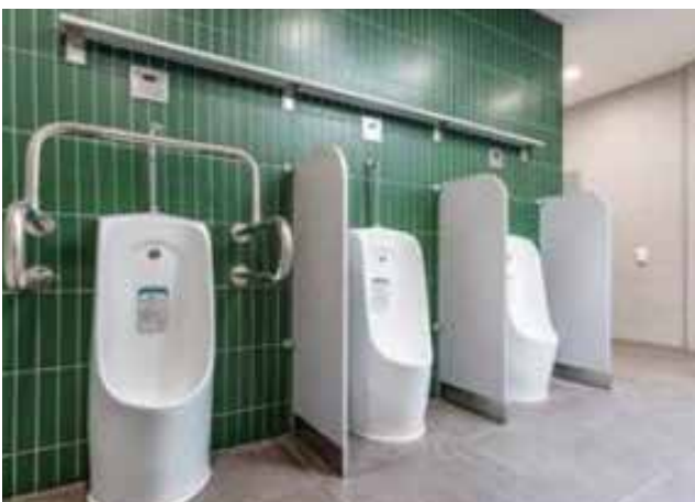
장애인 손잡이가 설치된 바닥형 소변기
