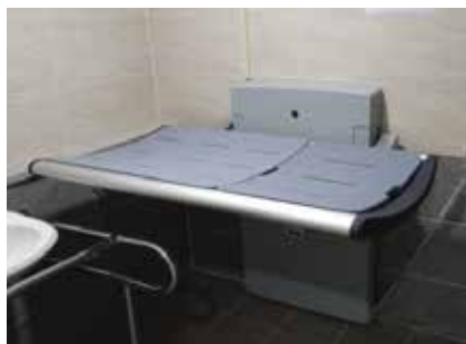
특수설비 설치 예시
