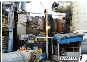
LNG버너 폭발 사고 / 2014
